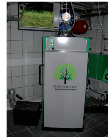
BIOKOMPAKT Biomassekessel 45 kW Wärme mit Stirlingmotor Quelle: LFS Tulln
