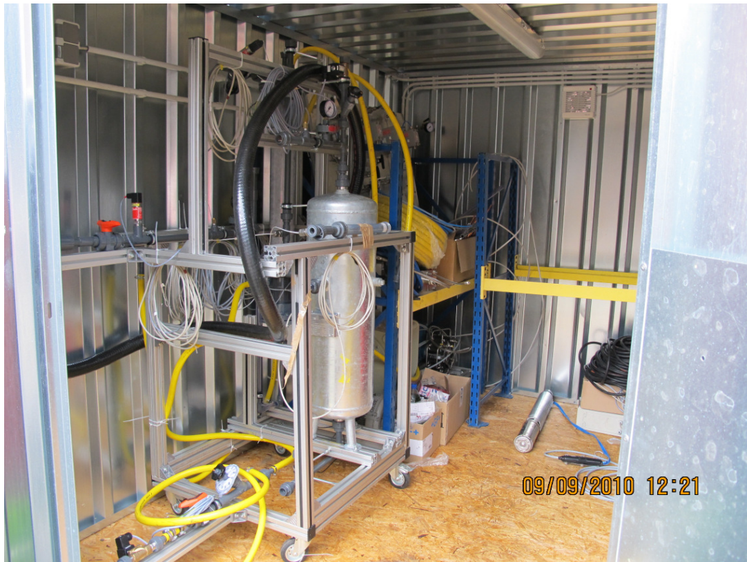
Abbildung 4: Technikumsanlage im Container am Standort „Sonnenhof“
