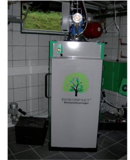
BIOKOMPAKT Biomassekessel 45 kW Wärme mit Stirlingmotor Quelle: LFS Tulln
