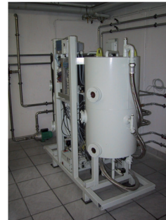
WEGRA Absorptions- kälteanlage 15 kW Kälte Quelle: IZES gGmbH
