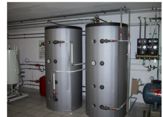
Wärme- und Kältespeicher Quelle: IZES gGmbH
