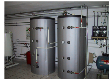
Wärme- und Kältespeicher Quelle: IZES gGmbH
