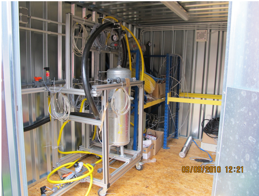
Abbildung 4: Technikumsanlage im Container am Standort „Sonnenhof“
