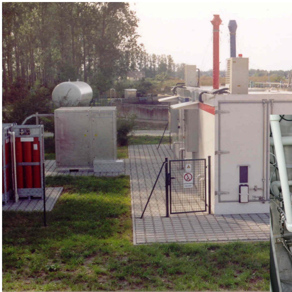
Installation im Klärwerk Barth Technische Daten Elektrolyseur:
